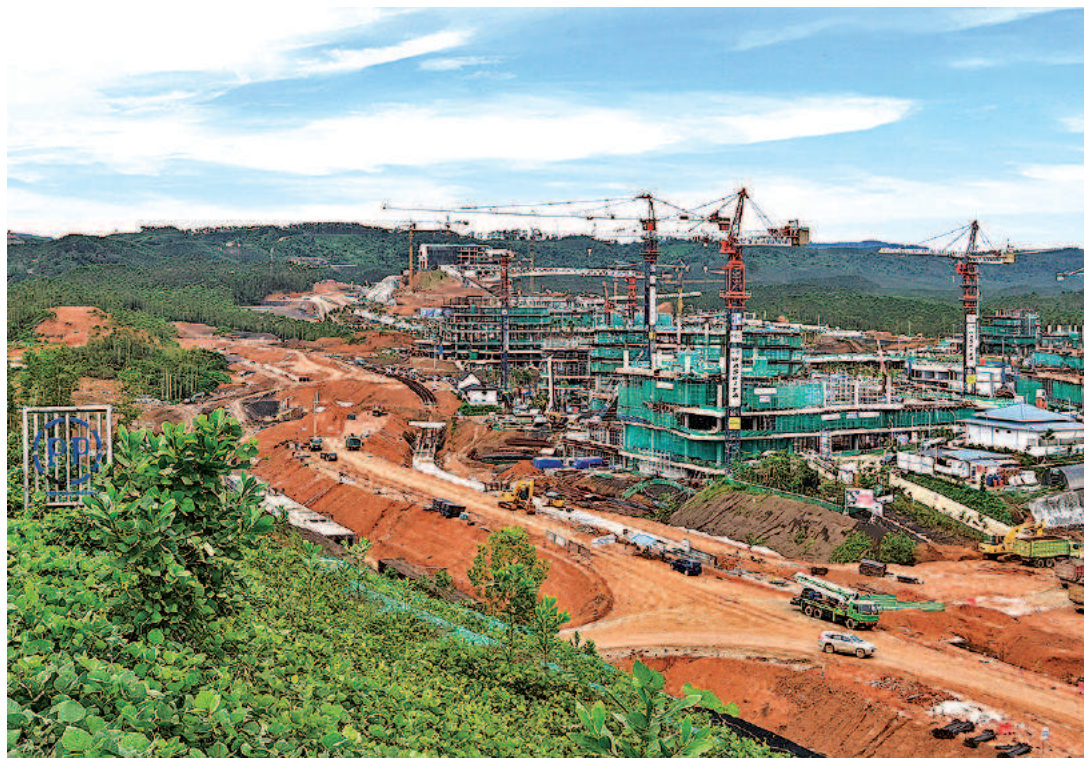
Pembangunan Kawasan Inti Pusat Pemerintahan (KIPP) Ibu Kota Nusantara (IKN) diabadikan dari ketinggian di Penajam Paser Utara, Kalimantan Timur, Kamis (7/12). Menurut Menteri Pekerjaan Umum dan Perumahan Rakyat (PUPR) Basuki Hadimuljono, progres pembangunan infrastruktur fisik IKN telah mencapai 60,3%.
