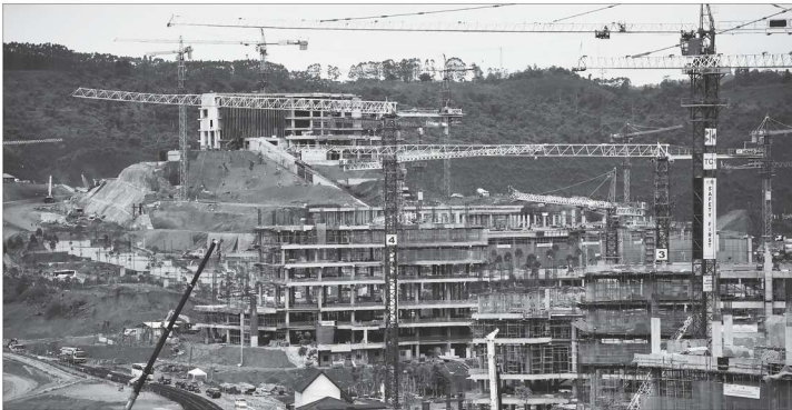
Suasana pembangunan Kawasan Irit Pusat Pemerintahan (KIPP) Ibu Kota Negara (IKN) Nusantara, Penajam Paser Utara, Kalimantan Timur, Kamis (7/12). Menteri Pekerjaan Umum dan Perumahan Rakyat (PUPR) Budi Setiadinjono melaporkan progres pembangunan infrastruktur fisik di ibu kota negara (IKN) Nusantara telah mencapai 60,3%.
